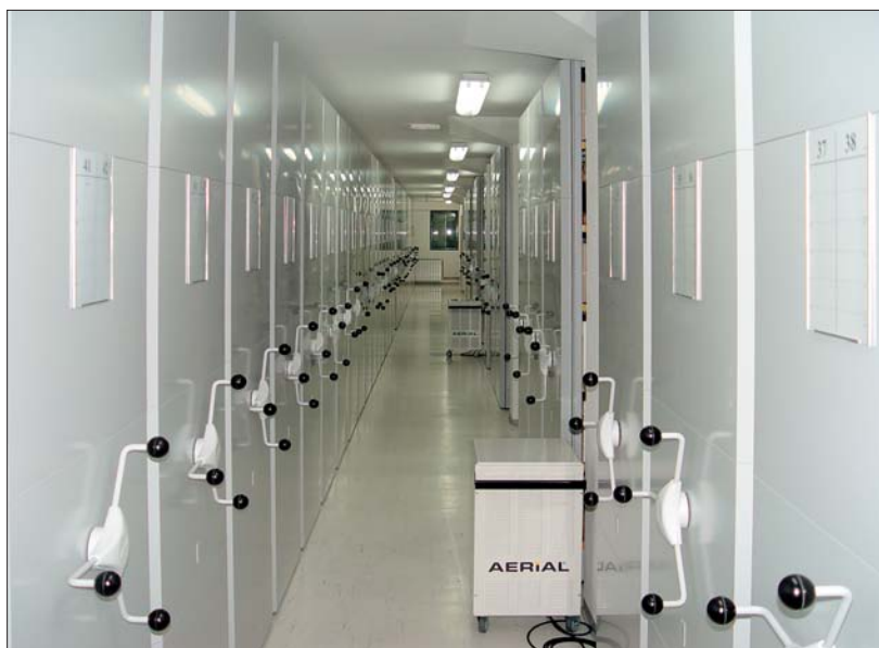
Suvremeno opremljeno arhivsko spremište s pokretnim regalima i odvlaživačima zraka.
